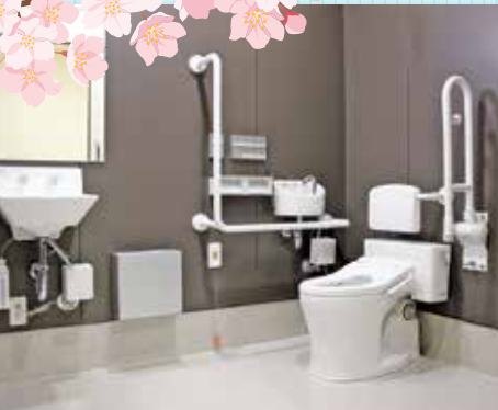
車いす用トイレ
